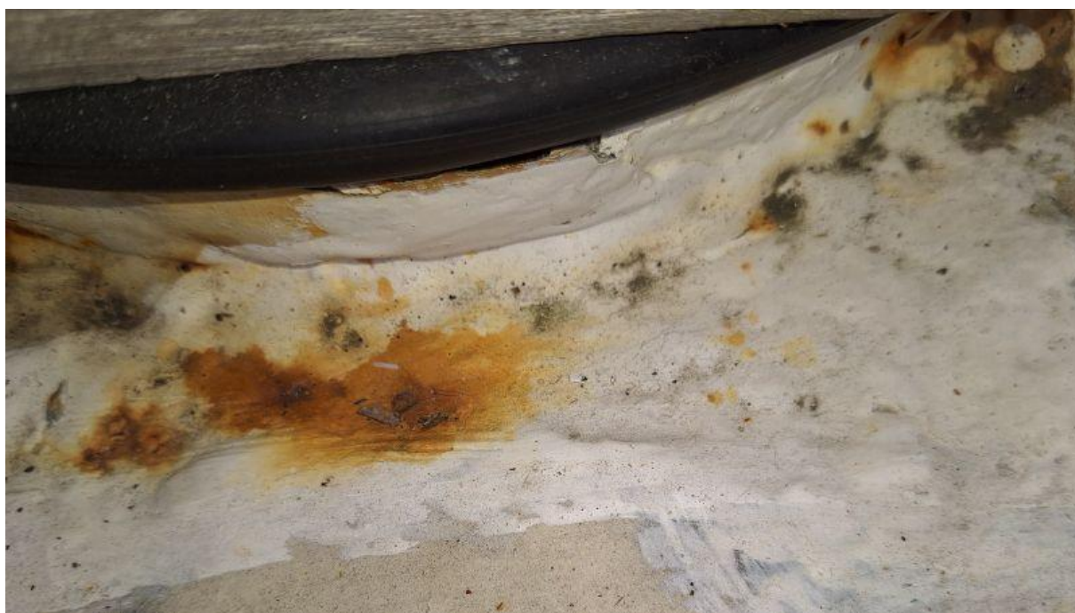
Rustig door met roesten.
