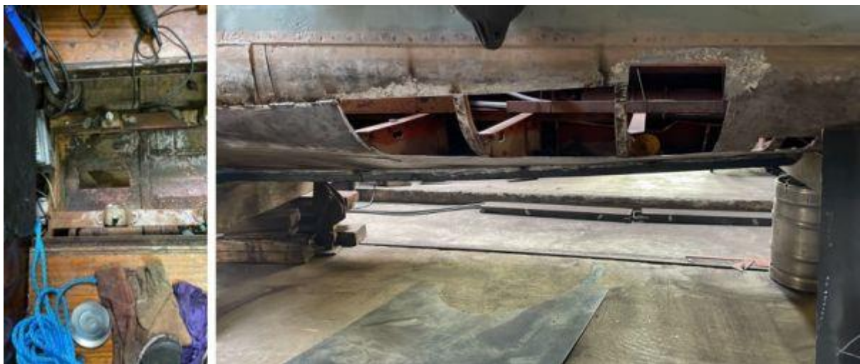
Het gat onder de motor en putcorrosie op de kimmen.
